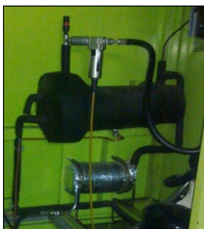
รูปที่ 3.3 ชุดควบคุมอุณหภูมิ
