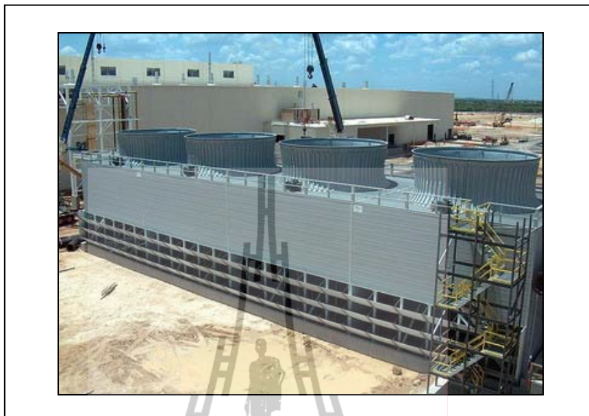
รูปที่ 2.3 Cooling tower ที่ทำจากวัสดุ FRP (Creative Pultrusions, 2004)
