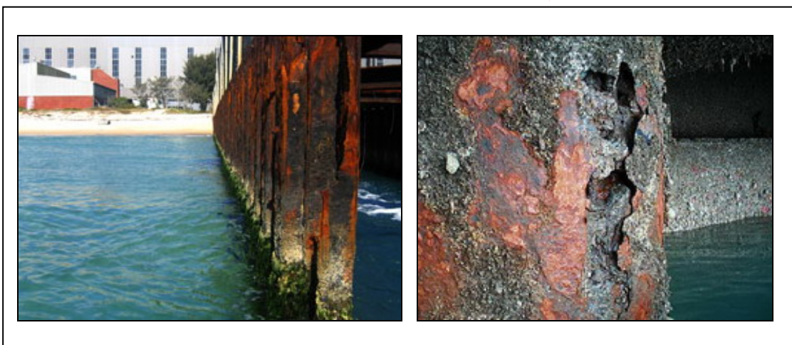
รูปที่ 1.1 สภาวะกัดกร่อนเนื่องจากสนิมในโครงสร้างเหล็กรูปพรรณ
