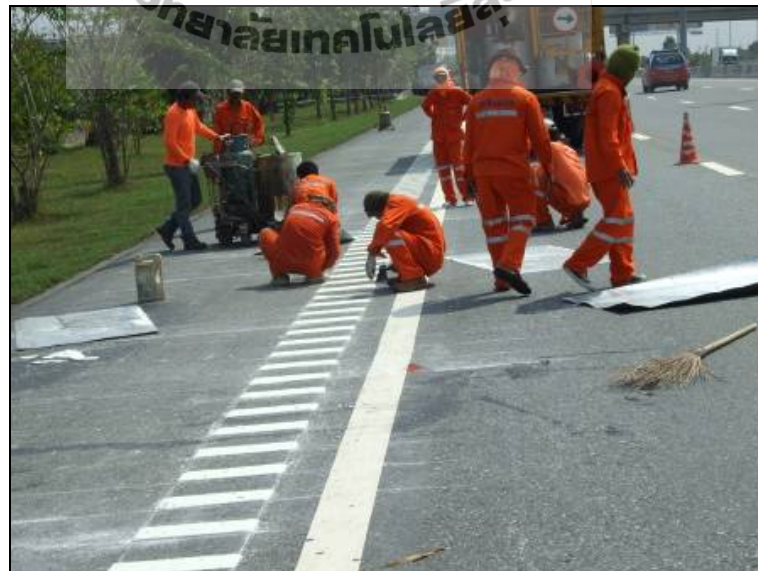
รูปที่ 3.7 การติดตั้ง Transverse Raised Shoulder Rumble Strips ที่มา : กรมทางหลวง, 2553.
