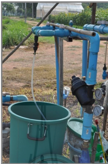
รูปที่ 2 ชุดจ่ายน้ำในระบบน้ำ
