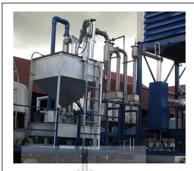
รูปที่ 3.5 ถังบำบัดน้ำ Flocculation Tank
