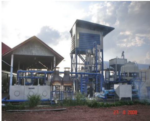
ก. โรงไฟฟ้าชีวมวลขนาดเล็ก
