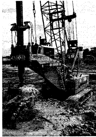
รูปที่ 2.13 เบนโทนไนท์ที่ใช้เพื่อป้องกันหลุมเจาะพังทลายในงานเสาเข็มเจาะ
