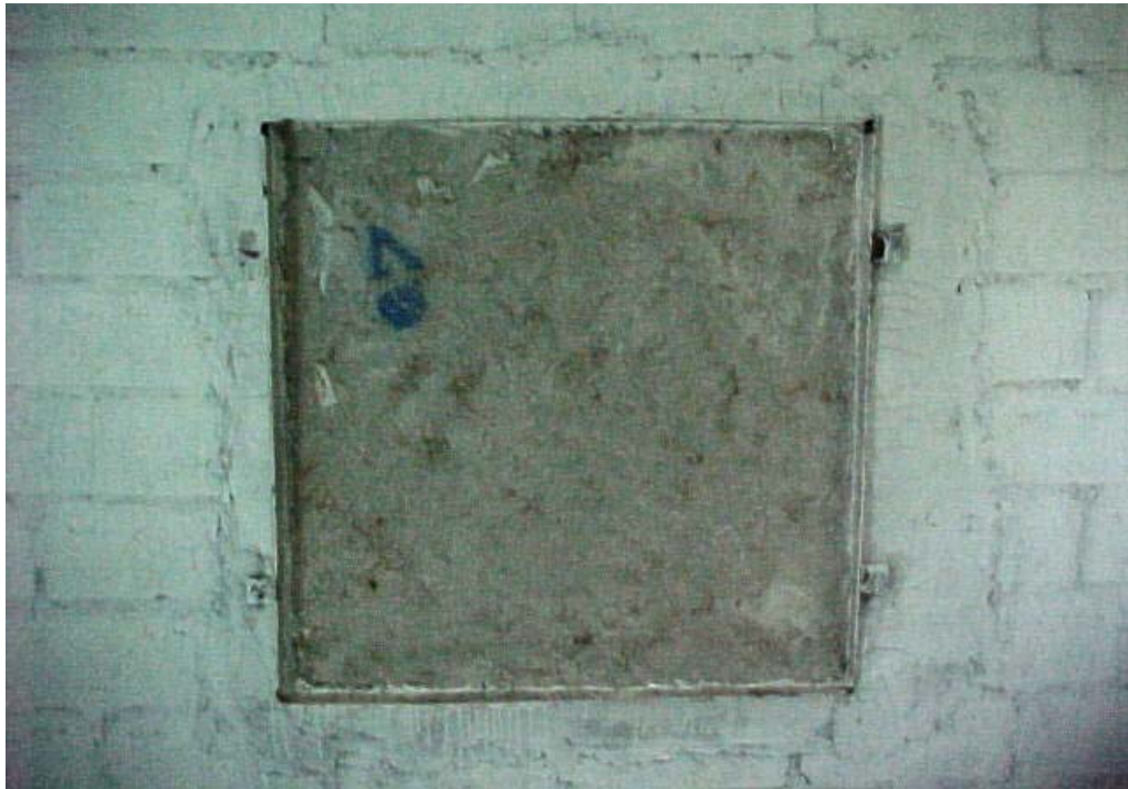
ภาพที่ 3.19 ลักษณะการติดตั้งแผ่นวัสดุ เพื่อทดสอบค่าการสูญเสียพลังงานเสียงขณะส่งผ่าน
