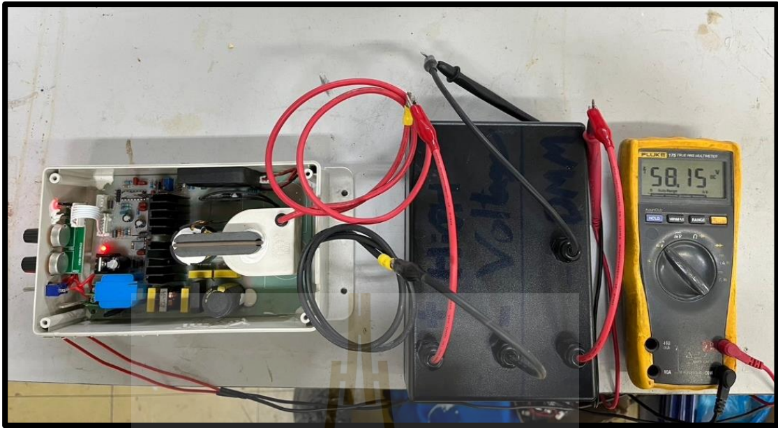
รูปที่ 4.3 วัดแรงดันไฟฟ้าสูงด้วย Digital Multimeter (DMM)
