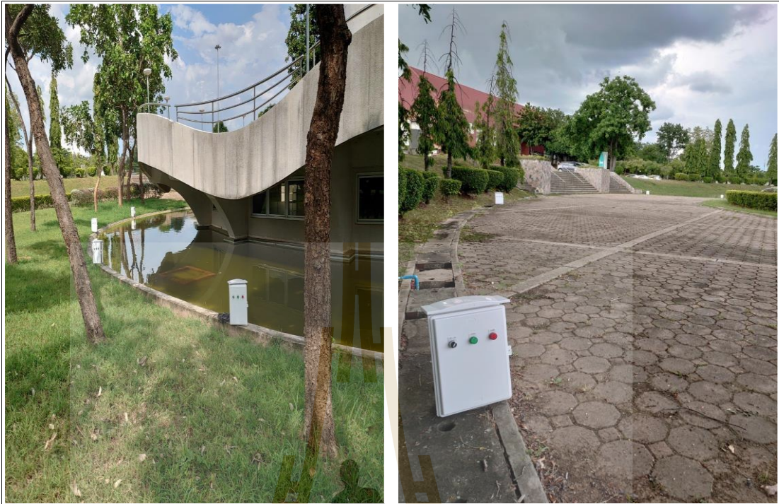
รูปที่ 4. 13 ติดตั้งสถานีย่อยสำหรับทดลองเก็บผลทดลองตามแหล่งน้ำสาธารณะและแนวท่อระบายน้ำ
