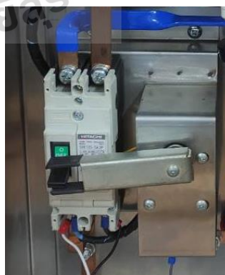
รูปที่ 3.7 เซอร์กิตเบรกเกอร์ OFF
