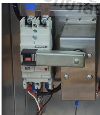
รูปที่ 3.6 เซอร์กิตเบรกเกอร์ ON
