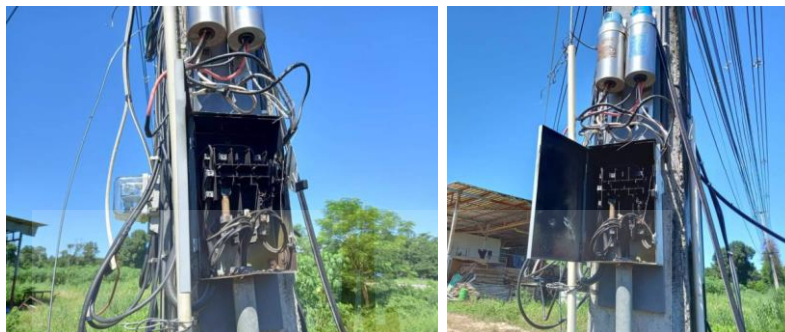
รูปที่ 1.1 การเกิดการเสียหายของระบบ Lighting control relay and safety switch
