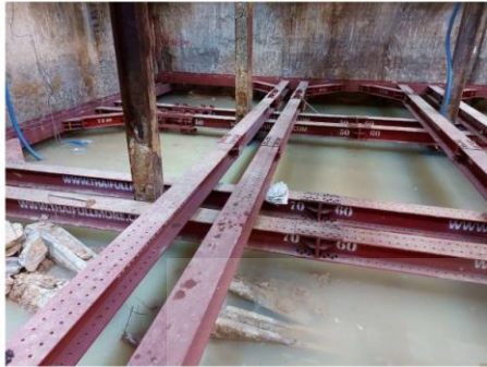
รูปที่ 20 ภาพถ่ายแสดงให้เห็นถึงระดับน้ำใต้ดินที่ไหลเข้ามาในบ่อเมื่อขุดดินถึงความลึก 20 เมตร หลังติดตั้งค้ำยันที่ 4
