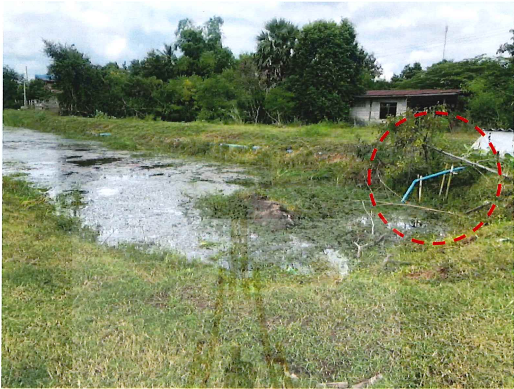
รูปที่ 4.16 ลักษณะการระบายรูปแบบที่ 2 (ไม่ใช้ท่อระบายน้ำสาธารณะและระบายลงสู่จุดรับน้ำเสีย)
