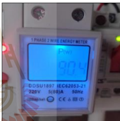
รูปที่ 3.8 อุปกรณ์วัดพลังงานไฟฟ้า
