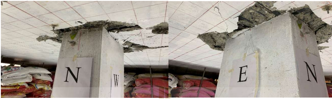
รูปที่ 4.25 ภาพได้แผ่นพื้นเมื่อแกะส่วนที่แตกร้าวที่หลุดร่อนบริเวณรอบหัวเสาออกหลังการทดสอบ
