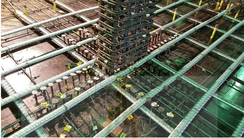
รูปที่ 3.9 ภาพถ่ายแสดงการเสริมเหล็กเสา ลวดอัดแรง และหมุดเอ็นในพื้นที่แบบจำลอง SS2
