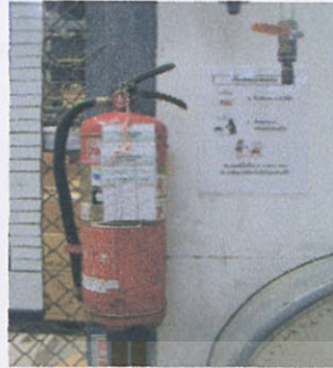
รูปที่ ข-2 ภาพการนำใบตรวจสอบถังดับเพลิงติดตามถังดับเพลิง
