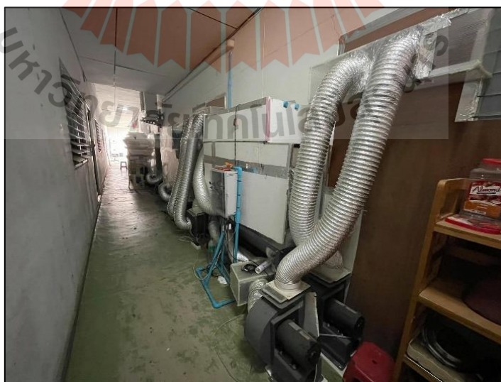
รูปที่ 4.29 การติดตั้งเครื่องทำความเย็นแบบน้ำระเหยที่ใช้แกนทำความเย็นแบบไหลตั้งฉาก สำหรับระบบปรับอากาศแบบไฮบริดที่ร้านสะดวกซื้อ
