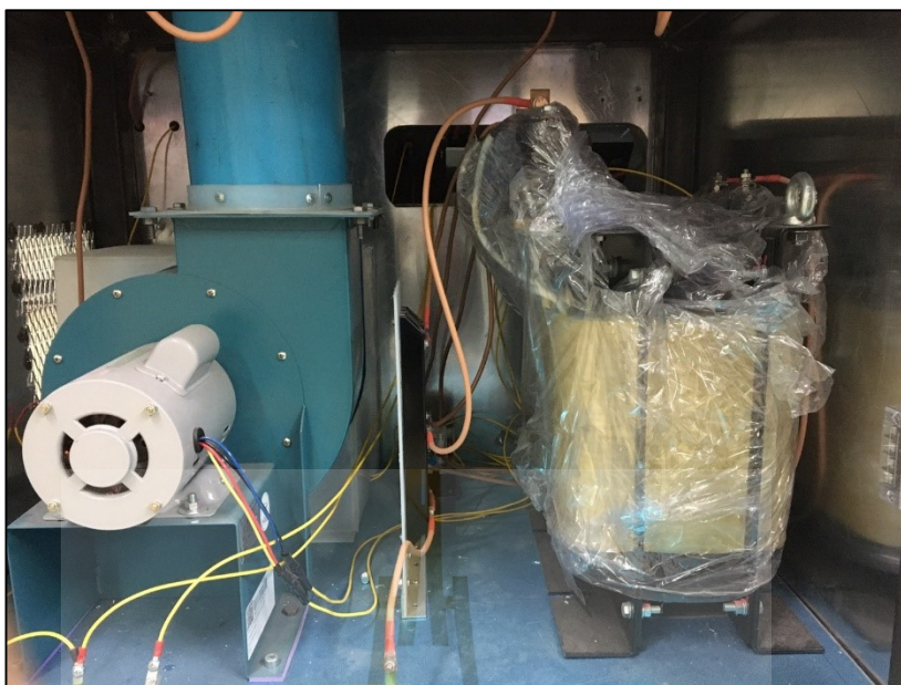
รูปที่ 3.6 แหล่งจ่ายกำลังงานที่ติดตั้งแล้ว
