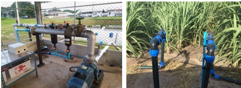
รูปที่ 3.13 การติดตั้งปั้มน้ำอัตโนมัติและโซลินอยด์วาล์ว
