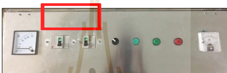
รูปที่ 4.35 แผงควบคุมระบบ
