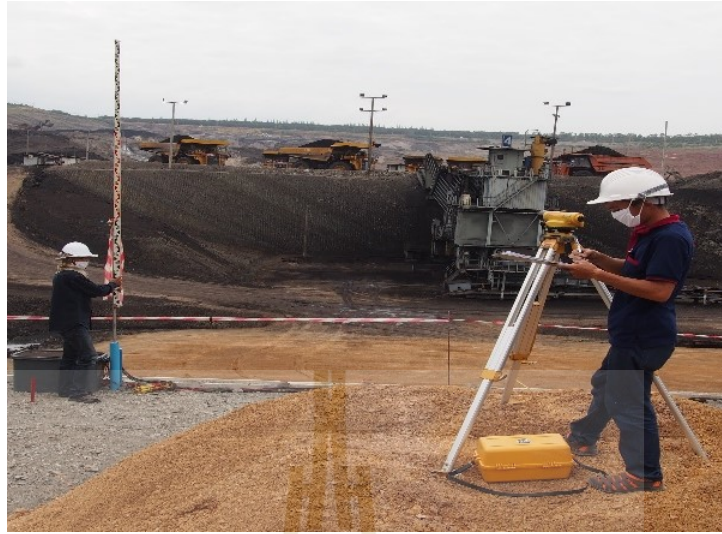
รูปที่ 3.4 แสดงการตรวจวัด Settlement Plate
