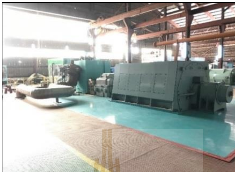
รูปที่ 3.20 กังหันขับเคลื่อนเครื่องกำเนิดไฟฟ้าขนาด 12 MW
