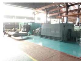
รูปที่ 4 กังหันขับเคลื่อนเครื่องกำเนิดไฟฟ้าขนาด 12 MW
