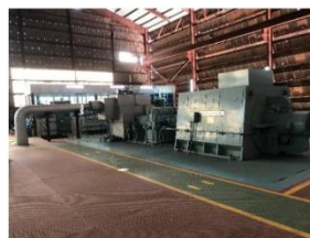
รูปที่ 3 กังหันขับเคลื่อนเครื่องกำเนิดไฟฟ้าขนาด 9 MW
