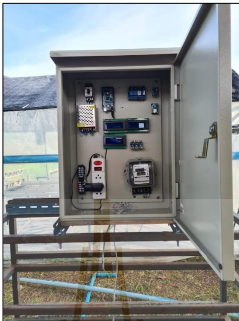
รูปที่ ค.9 ตู้ควบคุมการทำงานของระบบฟันทมออก
