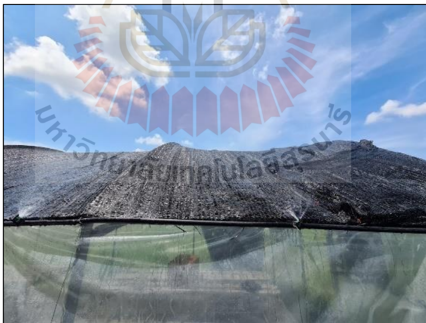
รูปที่ ค.2 ติดตั้งหัวสปริงเกอร์สำหรับการสเปรย์น้ำเพื่อลดอุณหภูมิให้กับตาข่ายพรางแสง
