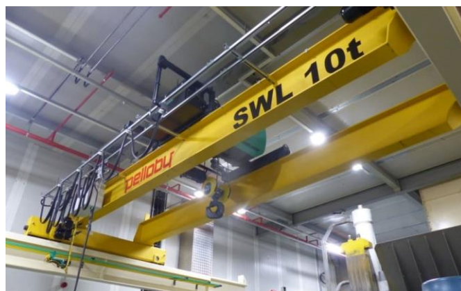
รูปที่ 2.18 แสดง Overhead Cranes (Double Girder)
