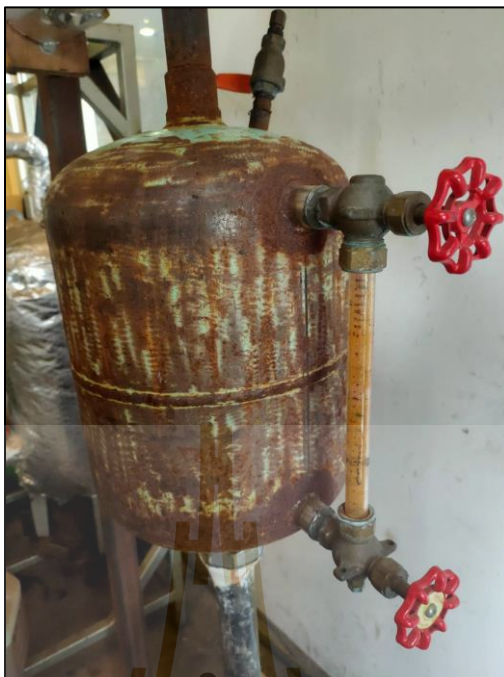
รูปที่ 3.4 ลักษณะของถัง receiver ในโรงไฟฟ้า
