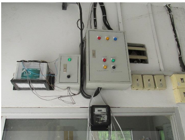
รูปที่ 3.3 การติดตั้งมิเตอร์ไฟฟ้า 3 เฟส บริเวณหน้าโรงพักไข้
