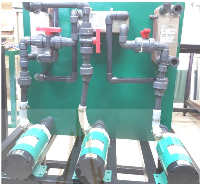
รูปที่ 3.9 ปัมของ strong tank, water tank และ weak tank
