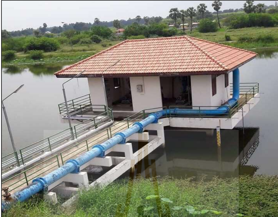
รูปที่ 3.3 แหล่งน้ำดิบเพื่อการประปา
