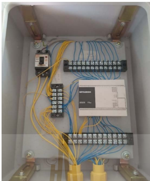
รูปที่ 4.12 ตู้ควบคุมไฟฟ้าสำหรับควบคุมการทำงานของเครื่องต้นแบบ
