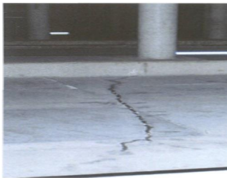
รูปที่ 2.2 การเกิด Drying Shrinkage Crack ของคอนกรีต โครงสร้างพื้น (ที่มา : ดร. สนธยา ทองอรุณศรี งานวิจัยเรื่อง การแตกร้าวเนื่องจากการหดตัวของคอนกรีต ปี 2551)
