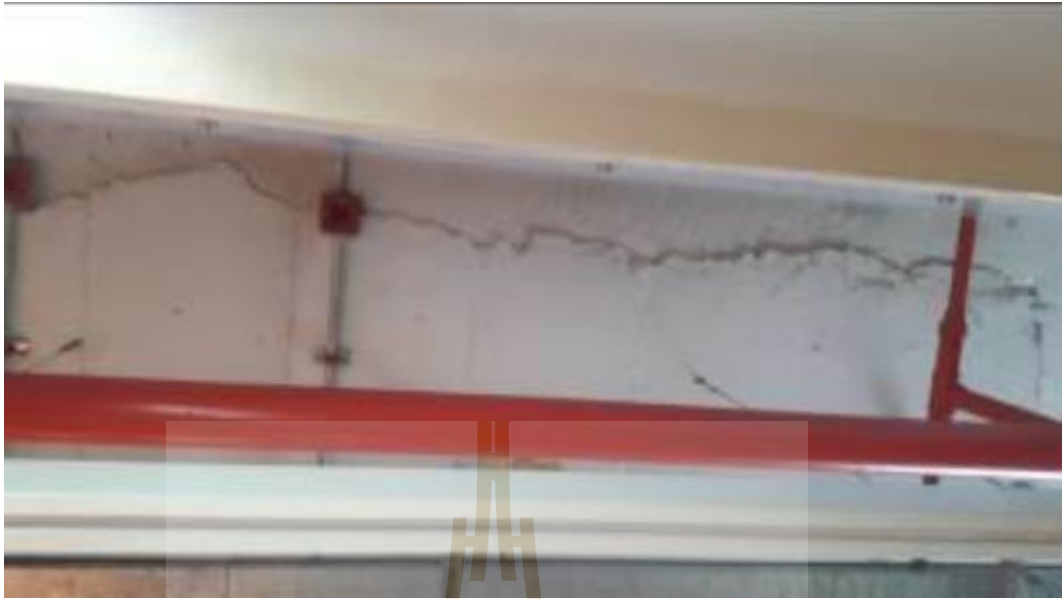
รูปที่ ก.3 ลักษณะรอยแตกร้าวของเพดานคอนกรีต
