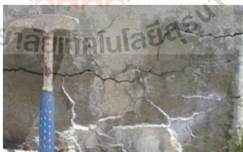
รูปที่ 2.9 การแตกร้าวคอนกรีตเนื่องจากด่างและมวลรวม (ที่มา : Cr. Concrete Technology C-PAC)
