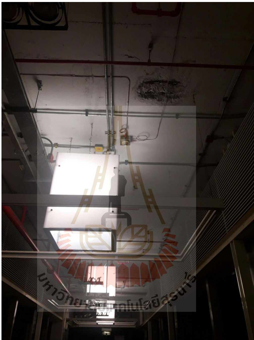
รูปที่ ก.1 บริเวณพื้นที่รอยแตกฝ้าของเพดานคอนกรีต
