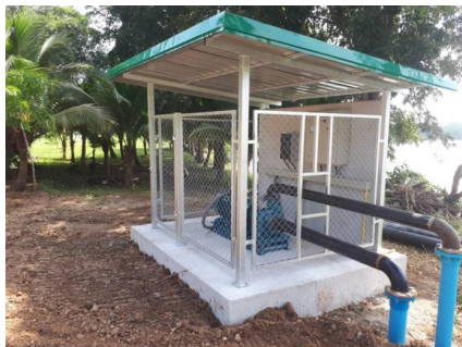
ภาพที่ 4 พื้นที่ติดตั้งระบบมอเตอร์สูบน้ำทั้ง 2 ประตุน้ำ
