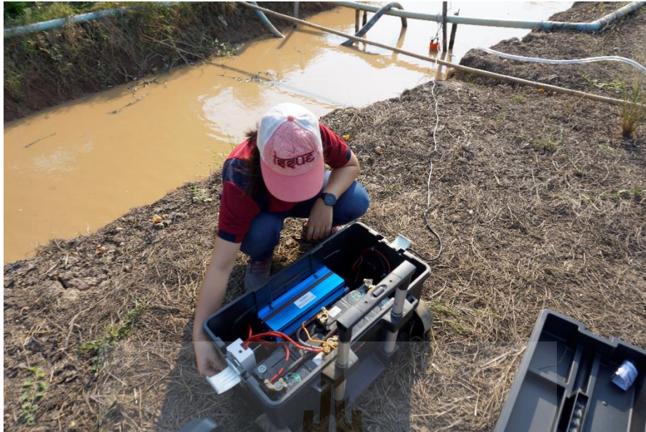
รูปที่ 3.12 นำชุดต้นแบบแหล่งจ่ายพลังงานไฟฟ้าพกพาทดสอบ ณ สวนขวัญนายโจ้ จังหวัดพิจิตร
