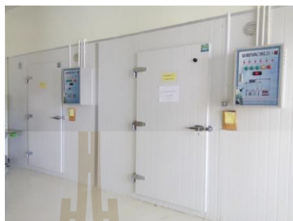
รูปที่ 3.17 ห้องเย็น
