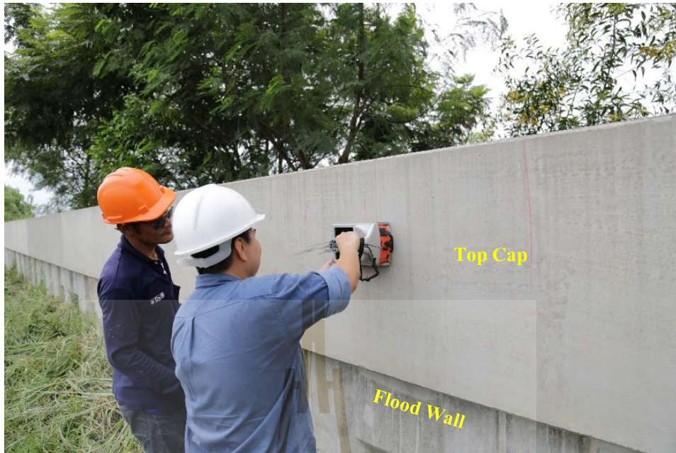
รูปที่ 4.2 การทดสอบสำรวจหาตำแหน่งเหล็กเสริม (Ferro scan)
