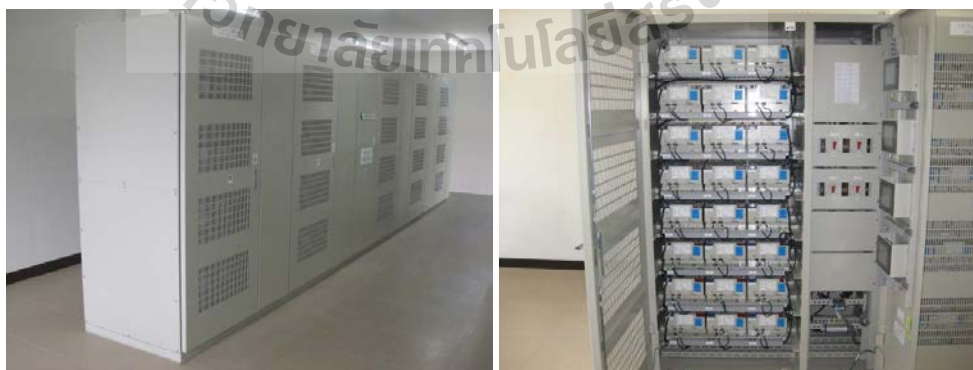
รูปที่ 3.16 ตัวอย่างการนำแบตเตอรี่ Li-ion ติดตั้งที่สถานี Hiraizumi เพื่อเก็บสะสมพลังงาน ที่มาภาพ : http://www.gsyuasa-lp.com/content/gs-yuasas-240kwh-lithium-ion-storage-battery-system-installed-hiraizumi-station-tohoku-line [เข้าถึงเมื่อ 16 ก.ย. 2560]
