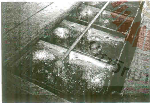
ฝาปิดบ่อน้ำแข็งซองเป็นไม้ และชำรุด
