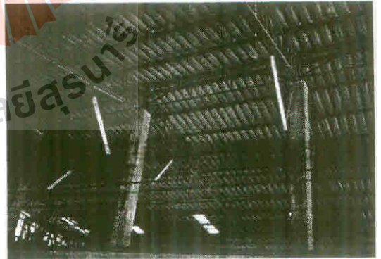
หลุดไฟไม่มีฝาครอบ
