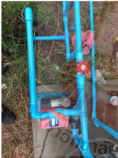
(ก) ระบบท่อและปั๊มส่งน้ำร้อน
