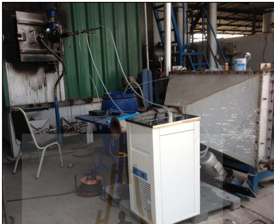
รูปที่ 3.6 เครื่องหล่อเย็นด้วยน้ำ
