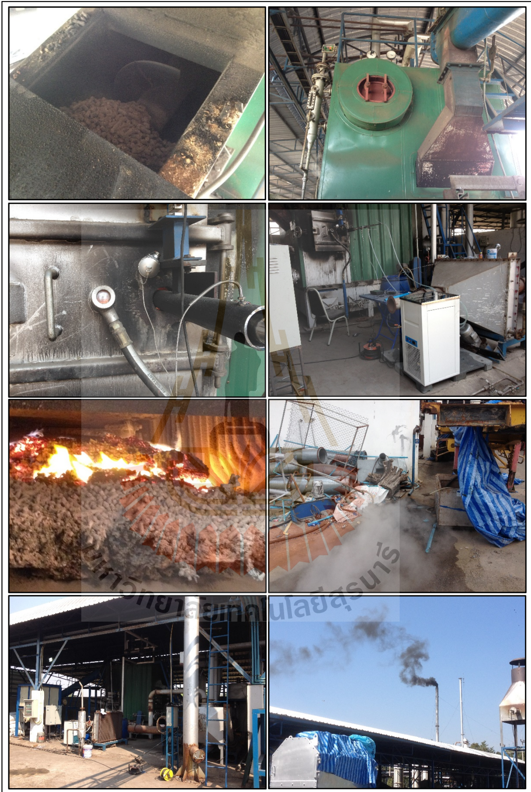
รูปที่ 4.15 กระบวนการทดสอบหม้อต้มไอน้ำ
