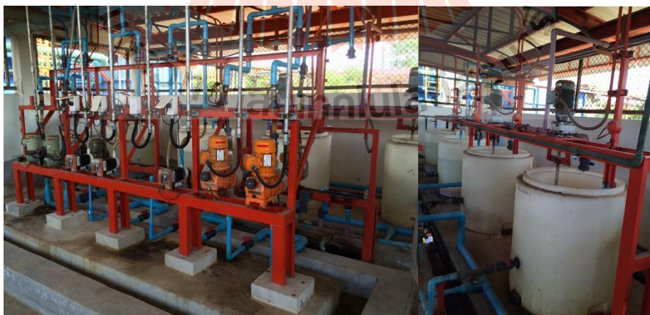
รูปที่ 2.6 ถังสารเคมีที่ใช้เติมให้กับระบบผลิตน้ำประปา (ระบบประปา มทส.)
