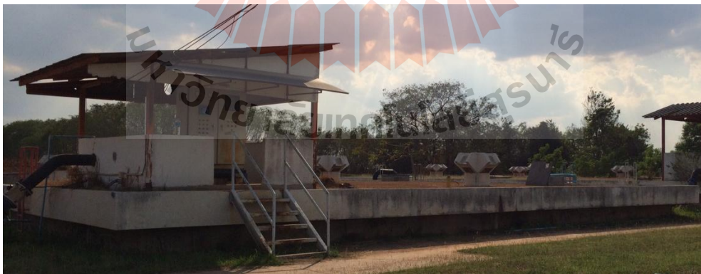
รูปที่ 2.10 ถังน้ำใส (ระบบประปา มทส.)
