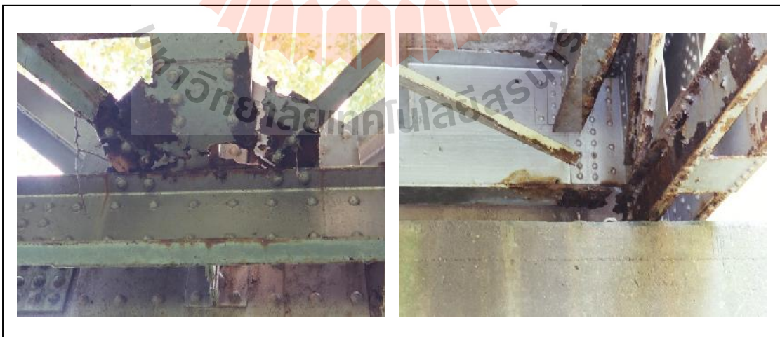
รูปที่ 1.1 สภาวะกัดกร่อนเนื่องจากสนิมในโครงสร้างเหล็กรูปพรรณ
