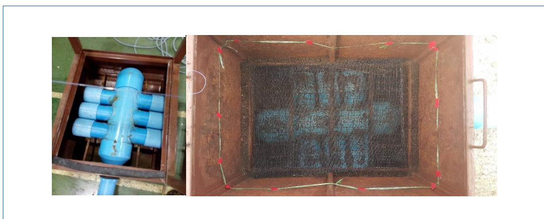
รูปที่ 4.11 ท่อกระจายอากาศของระบบตัวกรองชีวภาพแบบถาด
