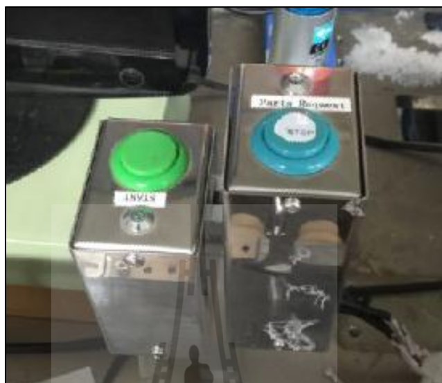
รูปที่ 3.19 แสดงการติดตั้งสวิตช์ควบคุมการทำงาน
