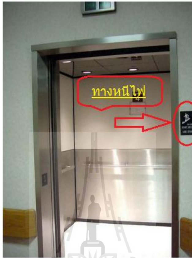
ตัวอย่างการติดตั้งป้ายบอกทางหนีไฟ
