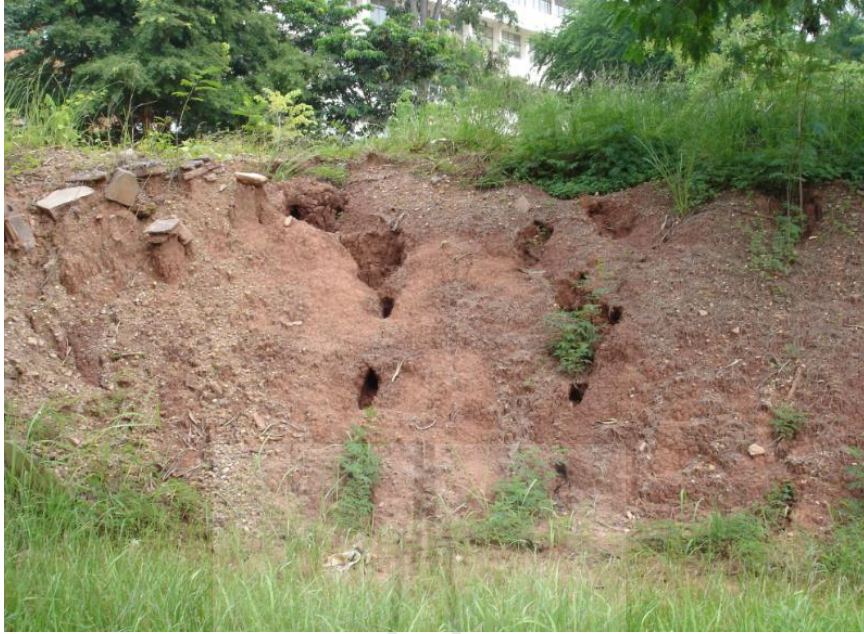
รูปที่ 1-2 การถูกกัดเซาะลาดดินจนเกิดเป็นโพรงบนลาดดิน พบในพื้นที่มหาวิทยาลัยเทคโนโลยี สุรนารี จังหวัดนครราชสีมา
