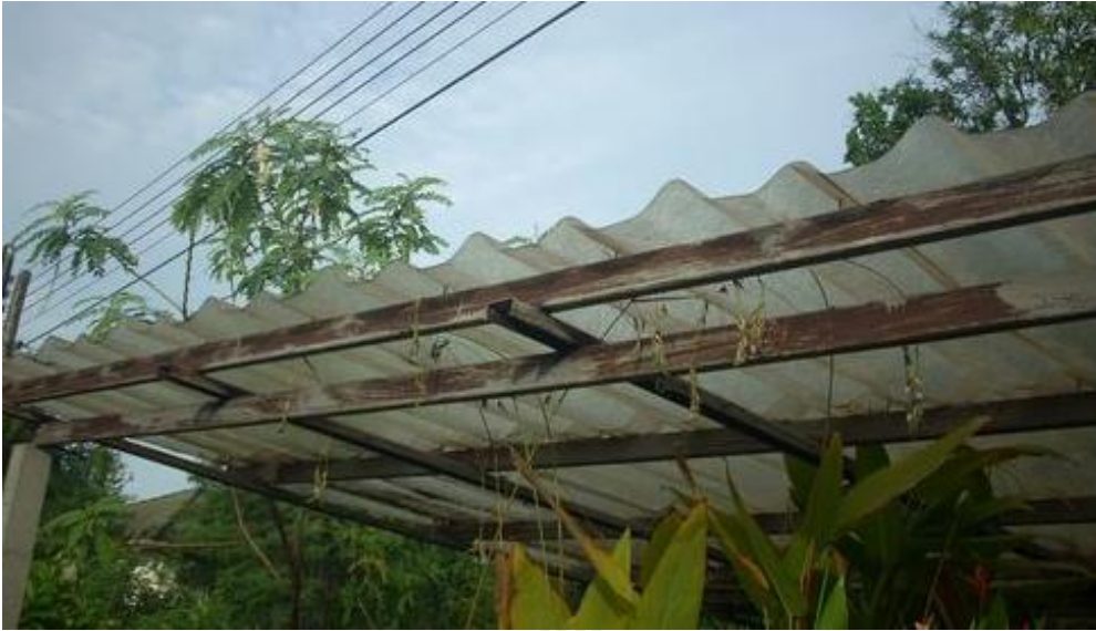
รูปที่ 3-4 โครงหลังคาโปร่งแสงคลุมพื้นที่ชุ่มน้ำประดิษฐ์
