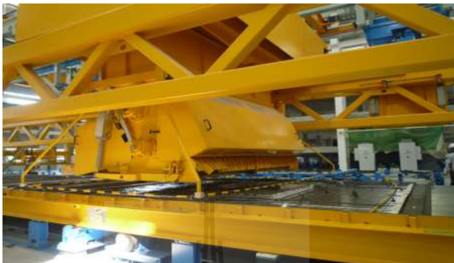
รูปที่ 2.7 การวางอุปกรณ์ และฝังท่อไฟก่อนการเท (Pruksa Real Estate , 2015)
