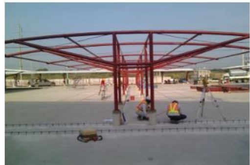
การติดตั้งตัวยึด โครงหลังคาเหล็กพร้อมทั้งปรับระดับ
