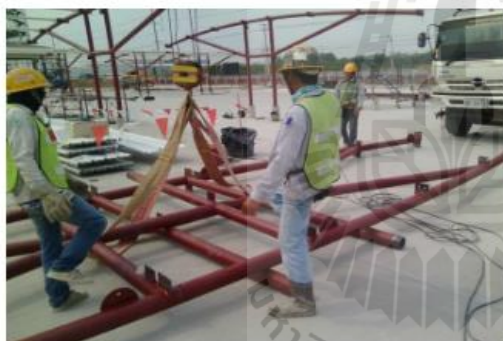
เกิดความผิดพลาดเลือกตัวโครงเหล็กผิดตัว, แก้ไขโครงหลังคาเหล็กใช้เวลา 2 ชั่วโมง
