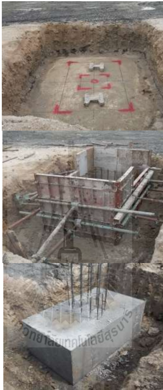
รูปที่ 4.3 กิจกรรมงานไม้แบบและคอนกรีตฐานราก
