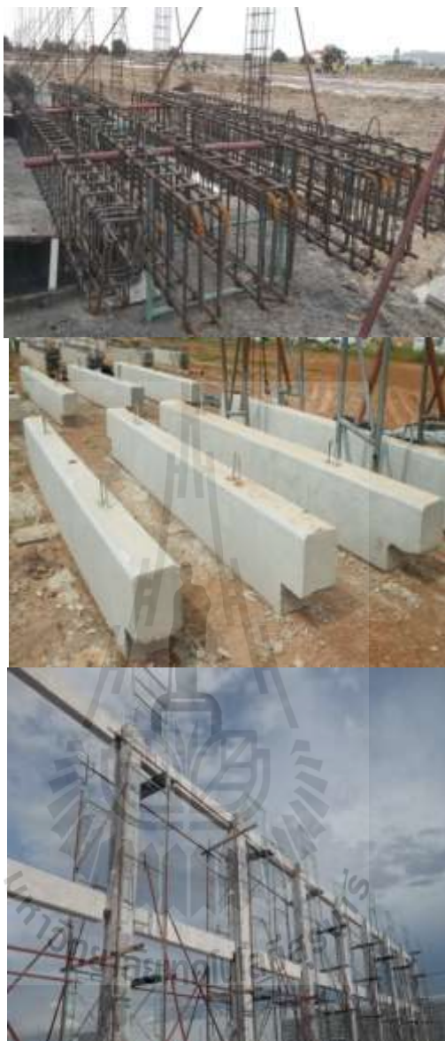
รูปที่ 4.6 กิจกรรมงานคานชั้นสองและคานชั้นสาม
