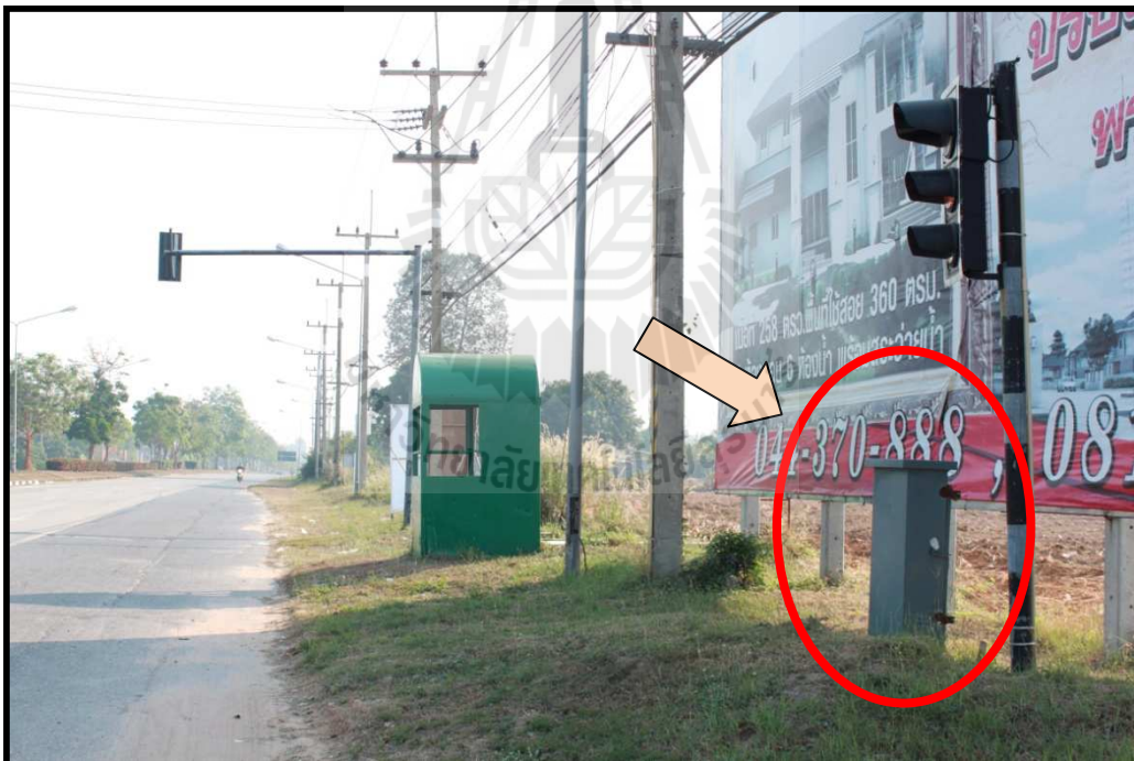
รูปที่.4.5 ตู้ควบคุมสัญญาณไฟจราจรที่ติดตั้งตรงบริเวณแยกการจราจร
