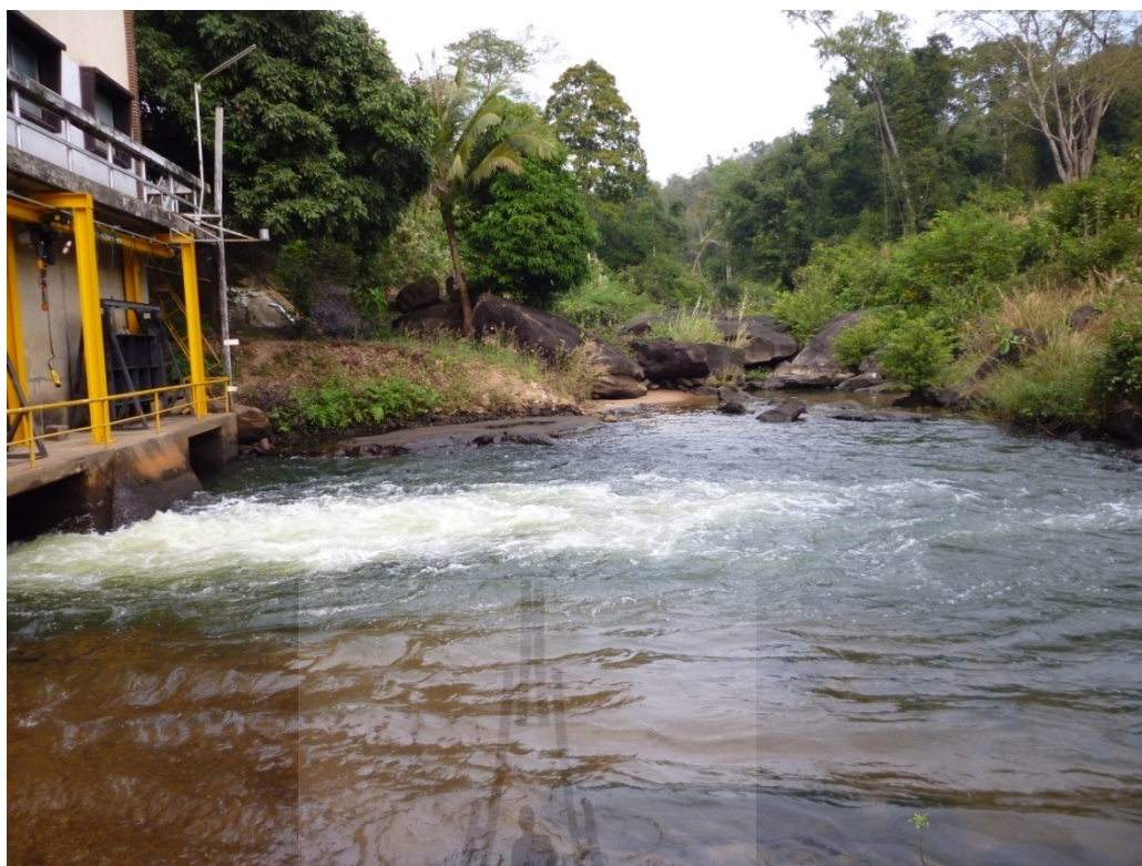
รูปที่ 3-5 จุดที่ 3 บริเวณทางน้ำออกจากโรงไฟฟ้า
